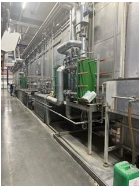
Abbildung 4: Prozessanlage mit mehreren Behandlungs- und Spülzonen. Bildbeschreibung: Die Prozessanlage mit mehreren Behandlungs- und Spülzonen. In diesen Bereichen werden die Bauteile gereinigt und vorbehandelt, bevor sie in den Lackier- und Trocknungsprozess gelangen.
